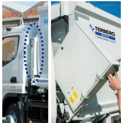
Cuadro eléctrico en frontal y abatido
